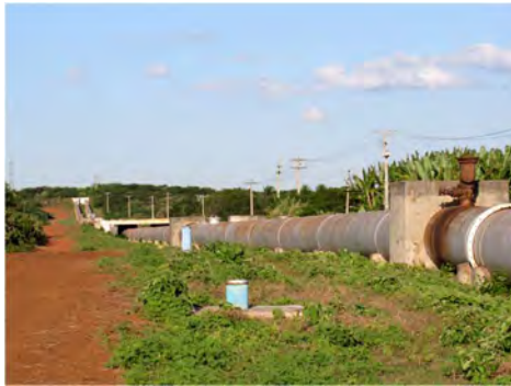
Captação e adução de água do DIBA no rio Açu
