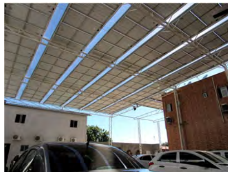
Painéis fotovoltaicos no estacionamento de hotel
